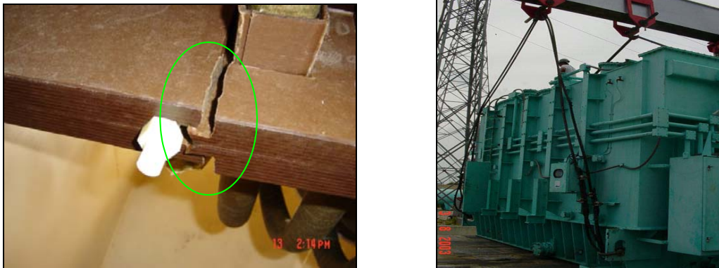
Figura 2.4 Ruptura de soportes aislantes debido a malas maniobras de puesta en servicio en un transformador de potencia (foto tomada durante la inspección interna). A la derecha: Transformador de potencia durante la maniobra.
